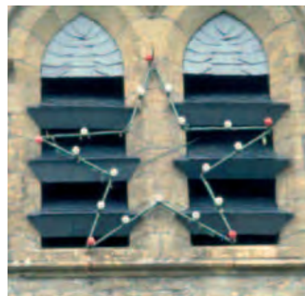
Le placement de luminaires de Noël à l'emplacement des entrées des refuges des chauves-souris est à éviter ou alors être étudié avec soin
